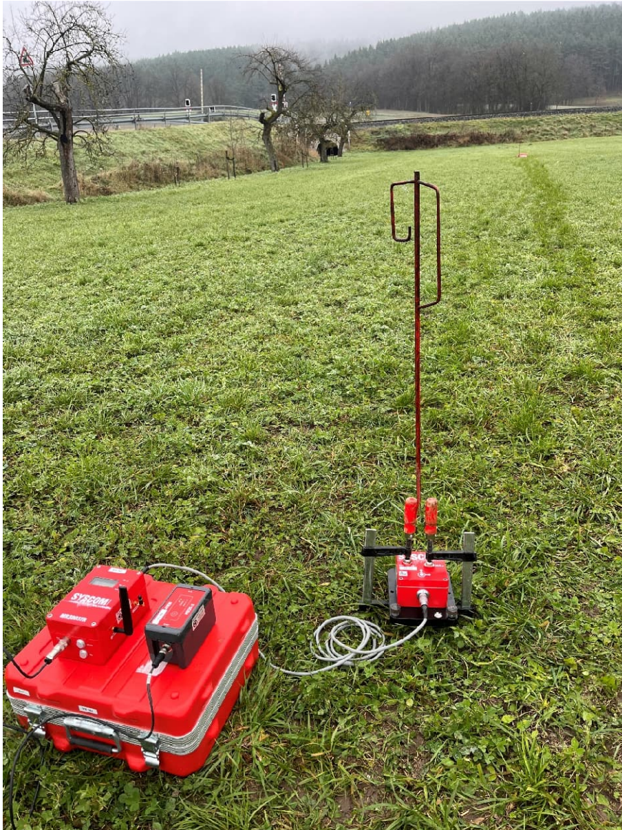
Abbildung 2: Installation des Schwingungsmesssystems MR162 auf einem Erdspieß am MP2 während des Messtermins vom 04.12.2024 (Entfernung zur Gleismitte: ca. 70 m; MP1 im Hintergrund)
